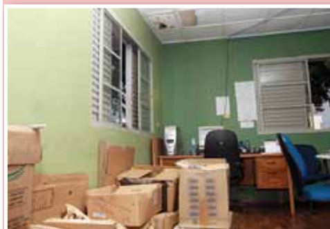
Na sala da QNA 39, servidores dividem espaço com caixas, fiação elétrica solta, teto mofado e quebrado
